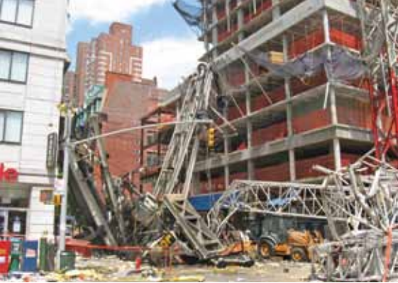
Zusammenbruch eines Baukrans: Das Sammeln von Informationen vor Ort an den Schadensstellen und die anschließende Dokumentation der Beschädigungen gehören zu den wichtigsten Aufgaben der forensischen Ingenieure.
